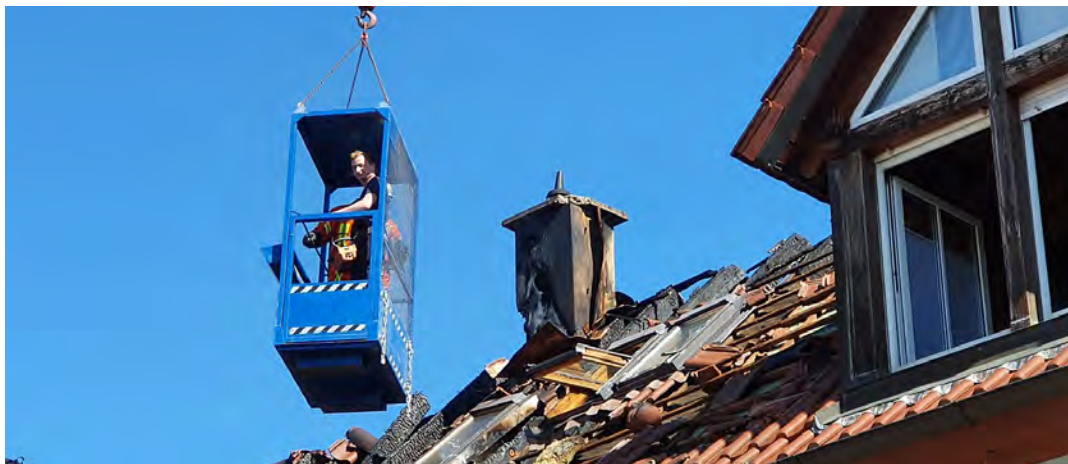
Am Tag nach dem Brand begutachteten Feuerwehrkräfte den Schaden von oben.
