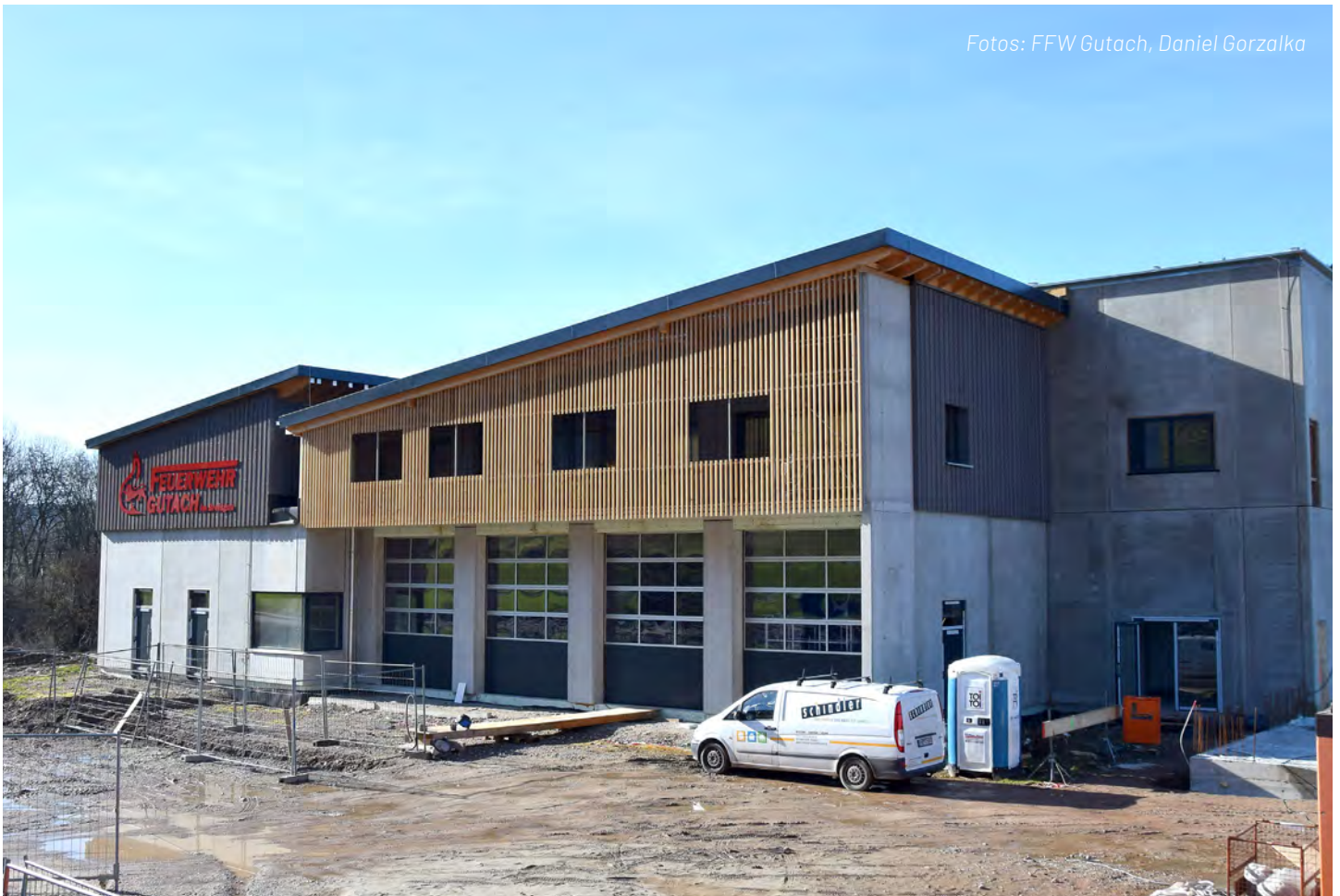
Das Obergeschoss wurde in Holzbauweise erstellt. Es beherbergt einen riesigen Versammlungsraum, das „Flori-Stüble“ für die Feuerwehrangehörigen, eine Großküche, sanitäre Anlagen, Büros und das Gemeindearchiv.
